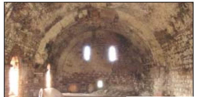
Κυρίως εικόνα: Η Χάνα στα Λουτρά της Τραιανούπολης Νομού Έβρου. Πρόκειται για κτίσμα οθωμανικής περιόδου (1375-1385) που χρησίμευε ως πανδοχείο Κάτω δεξιά: Λεπτομέρεια της εισόδου
