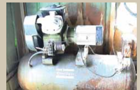
Εικόνα του αεροσυμπιεστή στο αντλιοστάσιο της γεώτρησης ΓΠ 22. Οι ζημιές που έχουν υποστεί τόσο ο αεροσυμπιεστής όσο και το αεροφυλάκιο απαιτούν την αντικατάστασή τους
