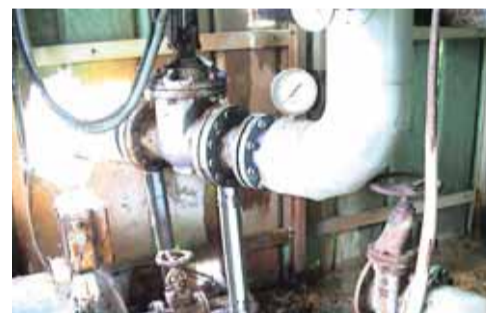
Άποψη του εξοπλισμού της γεώτρησης ΓΠ 22. Λόγω των εκτεταμένων διαβρώσεων που έχει υποστεί το σύνολο του εξοπλισμού.
