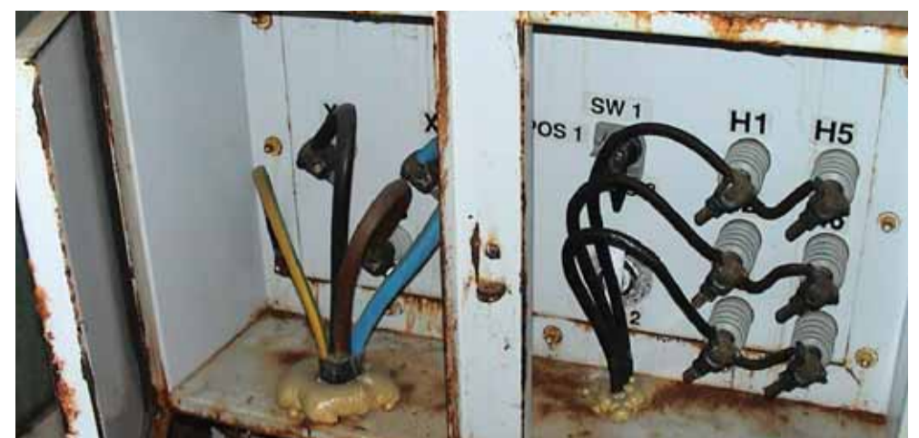
Άποψη των ακροδεκτών του μετασχηματιστή 400/890 V τροφοδοσίας του κινητήρα της αντλίας της γεώτρησης ΓΠ
