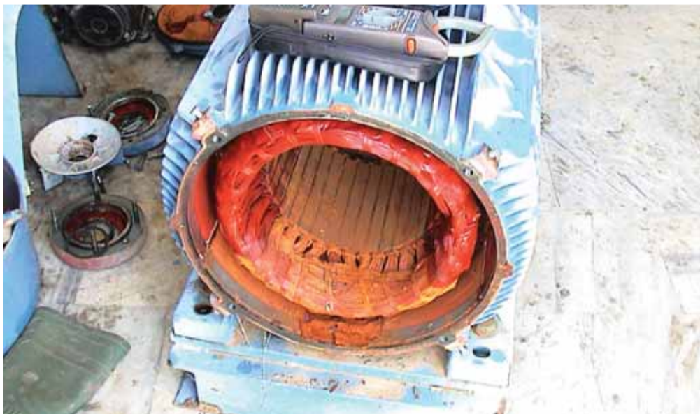
Άποψη του εσωτερικού ενός από τους κινητήρες των αντλιών του δικτύου επανέγχυσης. Διακρίνεται η συσσώρευση της λάσπης στα τυλίγματα και η προχωρημένη οξείδωση. Η ηλεκτρολογική εξέταση των τυλιγμάτων αποκάλυψε ότι αυτά έχουν καταστραφεί (τέλεια βραχυκυκλώματα μεταξύ τυλιγμάτων διαφορετικών πόλων).
