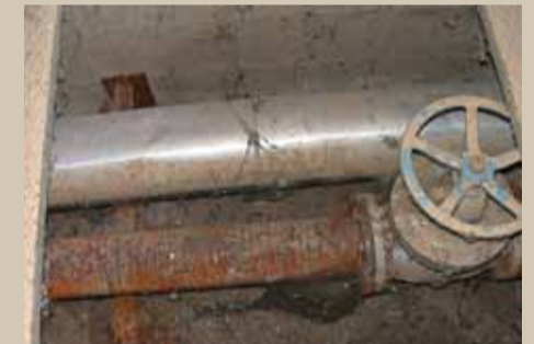
Αυτή την εικόνα παρουσιάζει το σύνολο των σωληνώσεων εντός των καναλιών.
