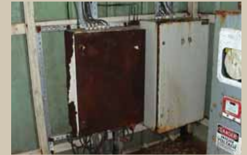
Εικόνα του κεντρικού ηλεκτρικού πίνακα, του πίνακα αυτοματισμού και ενός καταγραφικού οργάνου. Η διάβρωση είναι χαρακτηριστική.
