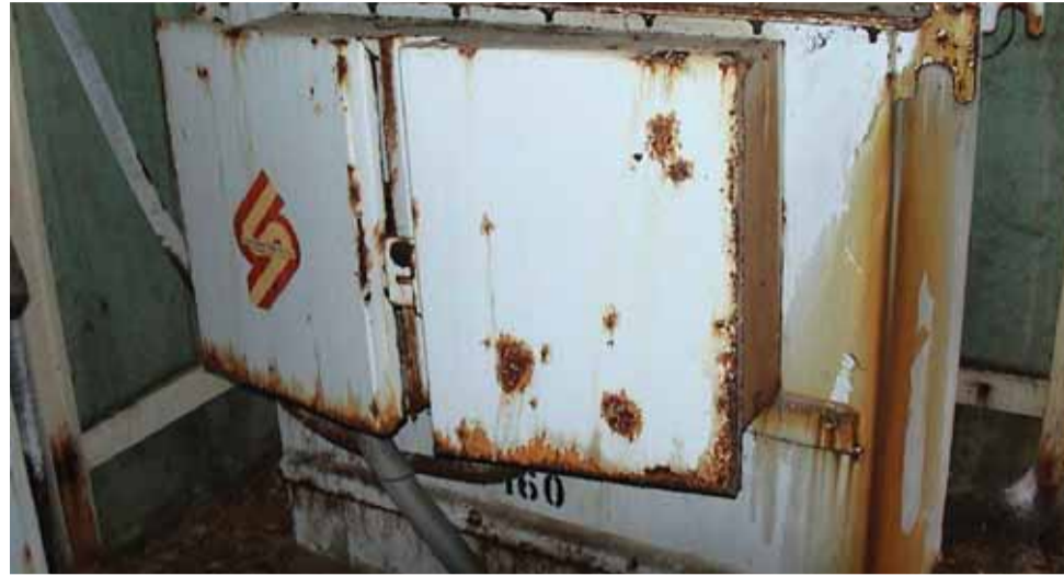
Άποψη του μετασχηματιστή 400/890 V τροφοδοσίας του κινητήρα της αντλίας της γεώτρησης ΓΠ 22, στο Γεωθερμικό Πεδίο Ν. Κεσσάνης.
