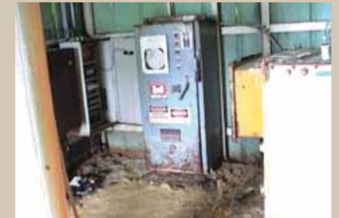
Γενικότερη άποψη του ηλεκτρολογικού εξοπλισμού γεώτρησης.
